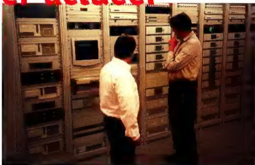
Controleruimte met multiplex, encryptie- en abonneesystemen van Digitenne in Hilversum.
